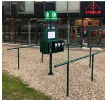
⋮ Eine E-Bike-Ladestation wurde beim Radhaus installiert.
