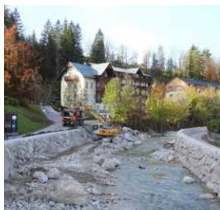
⋮ Hochwasserschutz Altausseer Traun
